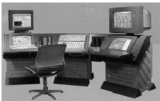
Fig. 14.5. Estação de operação típica do SDCD
